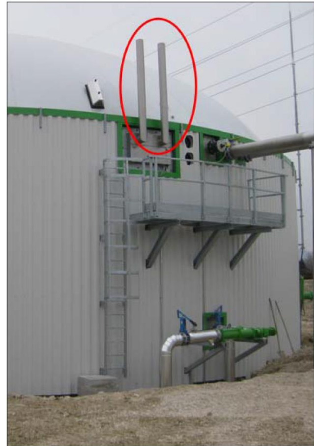
Figura 13. Il cerchio rosso identifica le due valvole di sicurezza.
