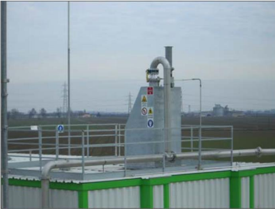
Figura 10. Valvola di sicurezza sul tetto del fermentatore EUCO.
